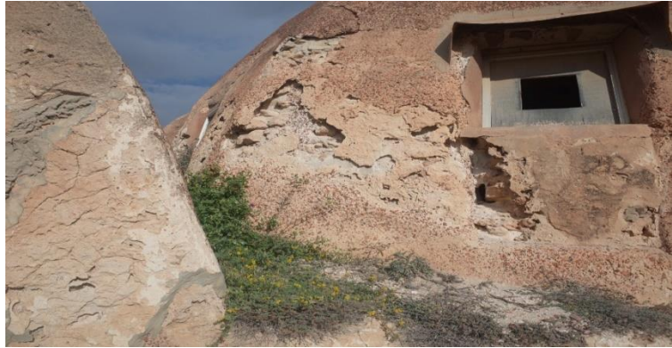
شكل رقم 10 يوضح سقوط طبقة المونة في مبني حمامات الصيد من تصوير
